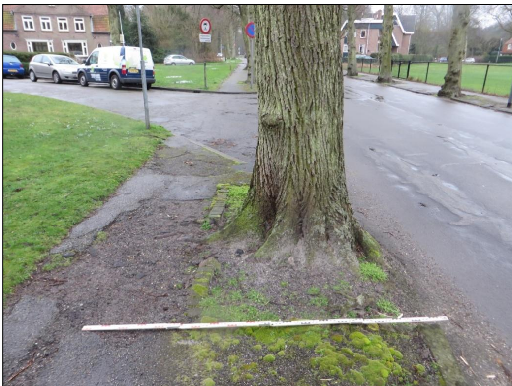
Het fietspad komt links van boom 9. (Zuidoostzijde laan). De wortelaanzet loopt tot 1,5 m uit de weg, in het trottoir zijn wortels zichtbaar.
